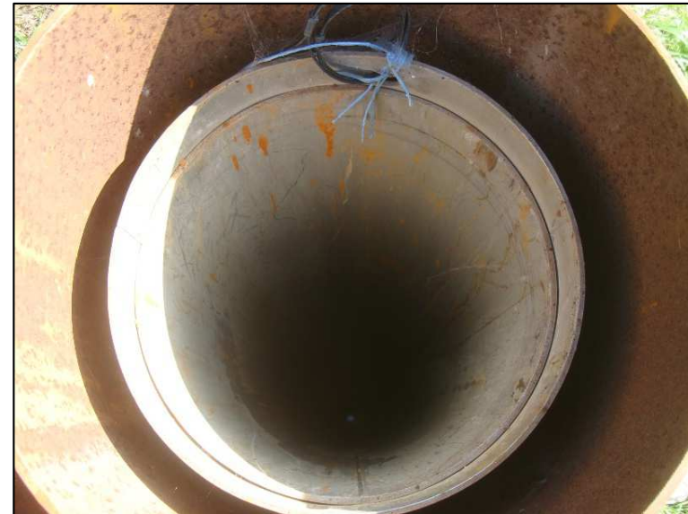
Vue de l'intérieur du forage F1 (tubage acier inox Ø 406 mm)
